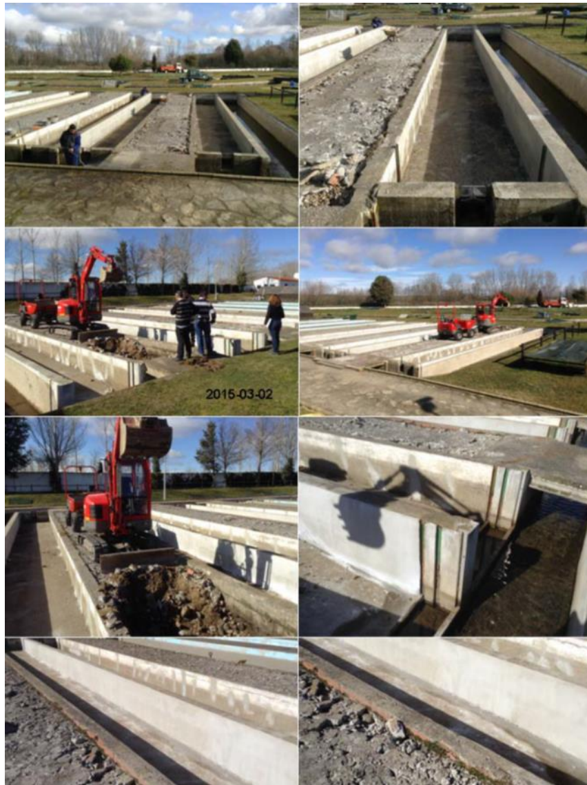
Obras de adaptación de los estanques del Centro Ictiográfico de Galisancho. Fecha: 2-Marzo-2015: eliminación de 3 pasillos de obra existentes.
